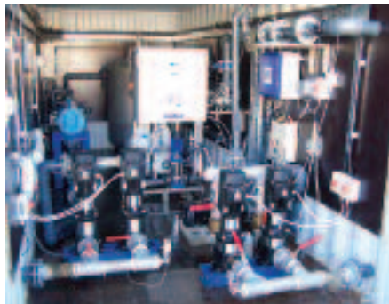
Burrischoole Temporary WTP, Co. Mayo
